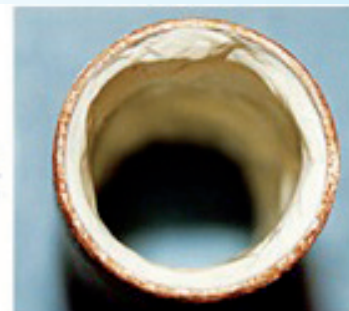
Wasserleitung mit Kalkablagerung vorher
